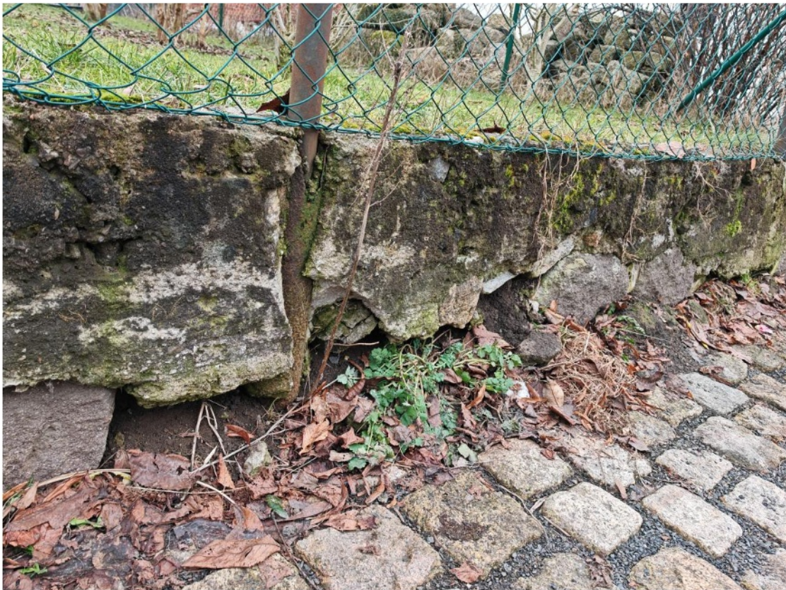
Obr. 8. Bližší pohled na podkopání podezdívky – úroveň přídlažby se zde nachází pod úrovní základové spáry.
