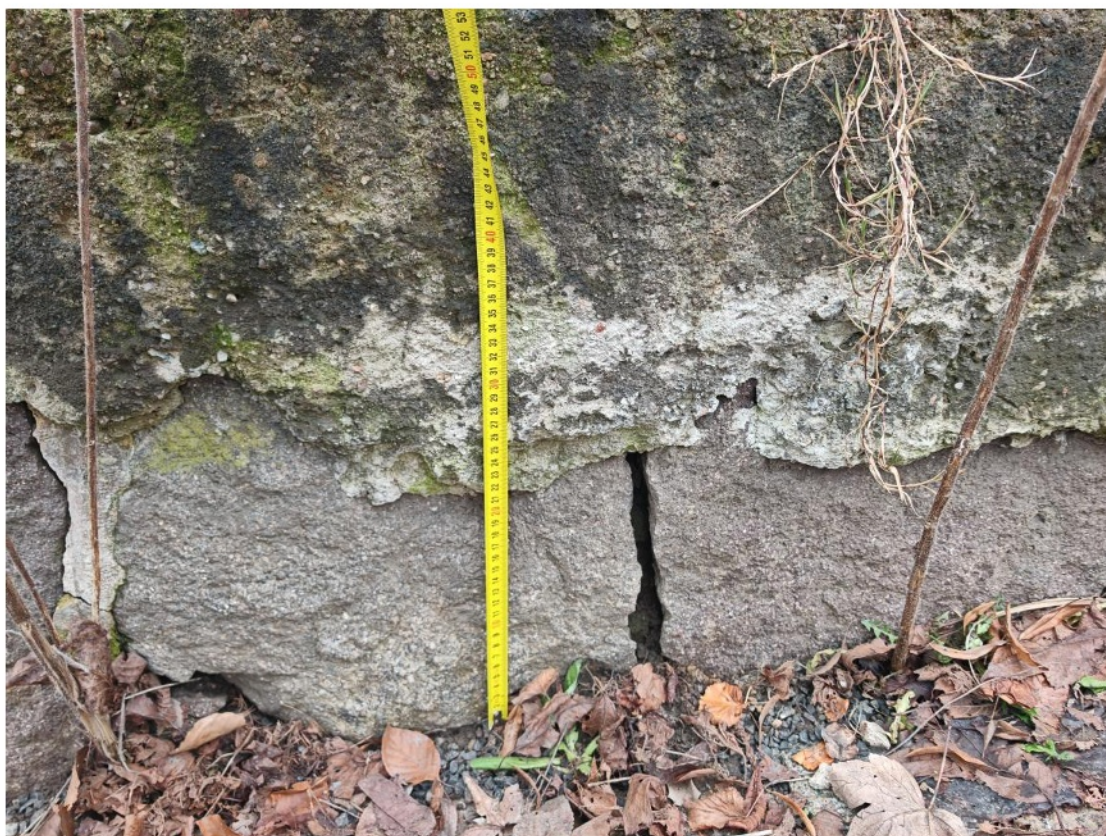
Obr. 9. Po opravě komunikace došlo k výraznému snížení výškové úrovně terénu; původní úroveň je patrná z bílé linie na podezdívce oplocení.
