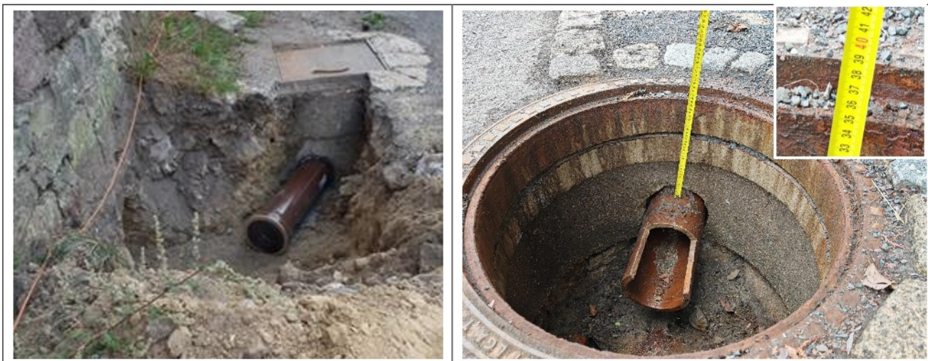
Obr. 14. Přímé porovnání hloubky uložení přípojky splaškové kanalizace. Vlevo realizace přípojky v roce 2022, vpravo současný stav v roce 2026. Z fotografie je patrné, že krycí vrstva nad potrubím je podstatně nižší, a to o rozměr jedné betonové skruže.
