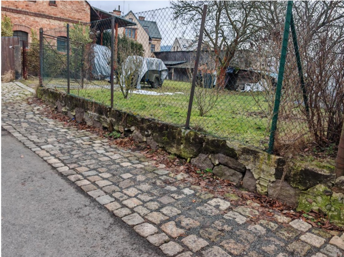
Obr. 7. Pohled na podezdívku oplocení. Místy je podezdívka podkopána a je proto ohrožena stabilita plotu (jeden z ocelových sloupků vykazuje nadměrnou výchytku).
