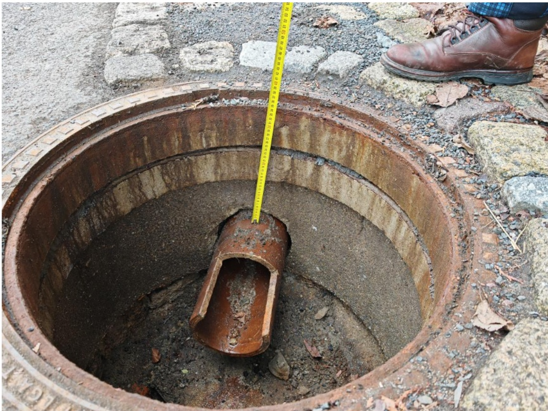
Obr. 12. Krytí přípojky i níže situovaného kanalizačního řadu je zcela nedostatečné.
