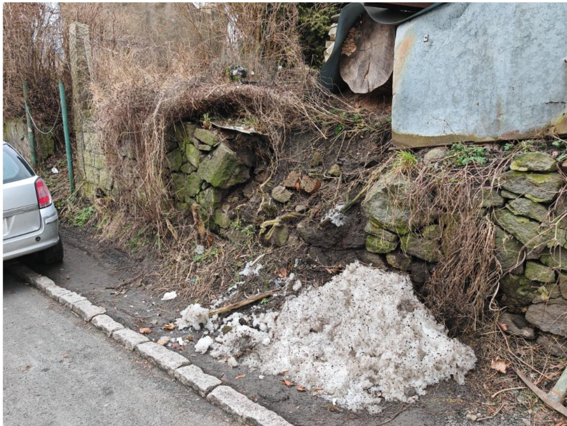
Obr. 10. Pohled na opěrnou zeď po opravě komunikace. Prováděné stavební práce přispěly ke zhoršení technického stavu (který nebyl dobrý již před zahájením opravy komunikace).
